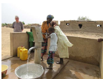
Forage rééquipé d'une pompe Vergnet
