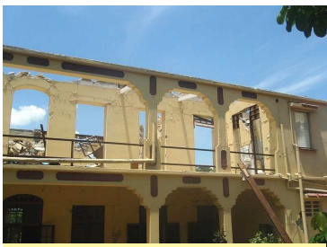
Bâtiment endommagé du Centre Rosalie
