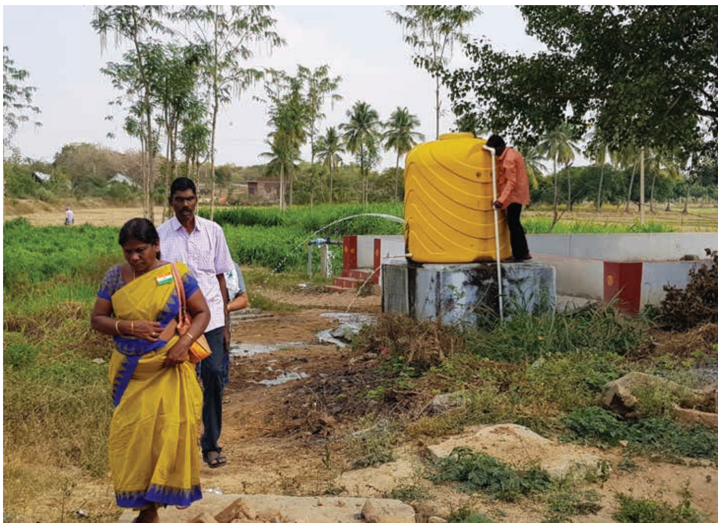
Une pompe électrique et son réservoir, à Mandanavery
